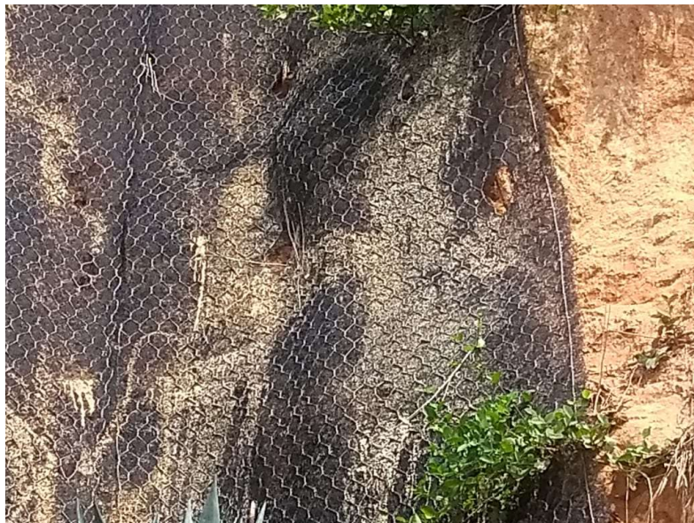
Figura 15: Geossintético deteriorado pela ação do tempo
