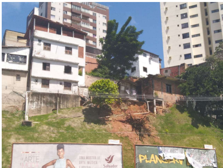
Figura 21: Local com cicatriz de movimento de massa na região da Avenida Vasco da Gama
