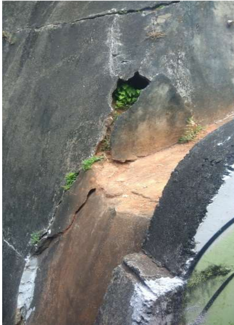
Figura 7: Movimento de massa rotativo e Spoon Structure
