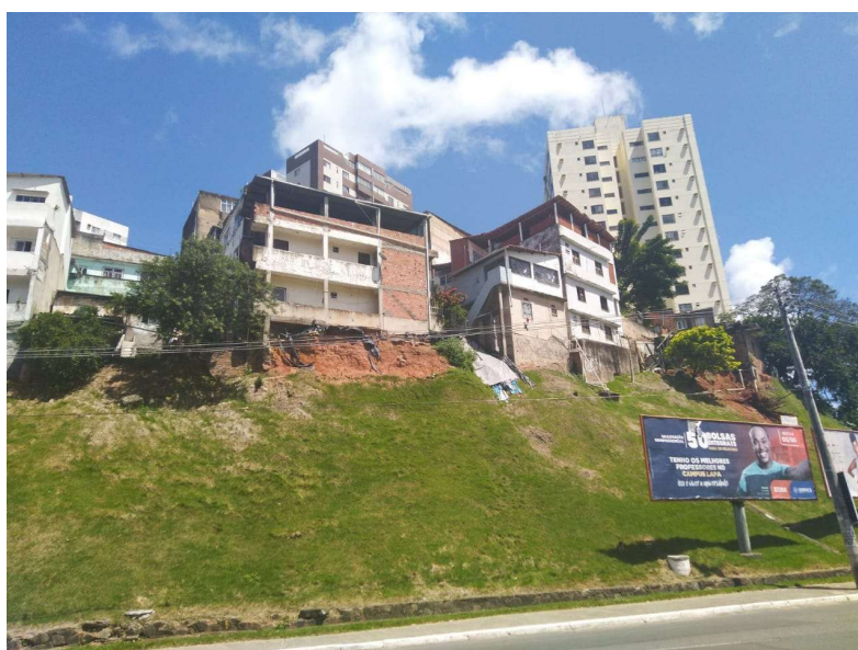
Figura 22: Local com cicatriz de movimento de massa na região da Avenida Vasco da Gama
