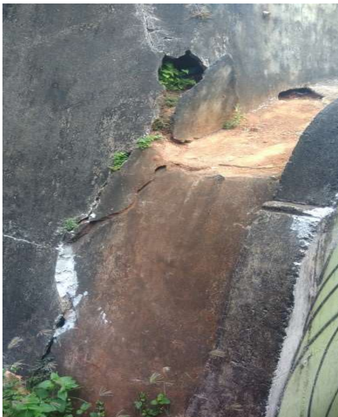
Figura 8: Fraturas presentes na estrutura
