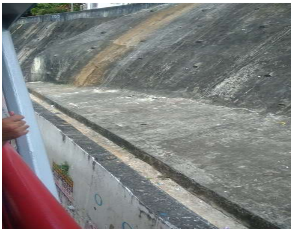
Figura 5: Mal acabamento nas regiões limítrofes e fissuração da estrutura
