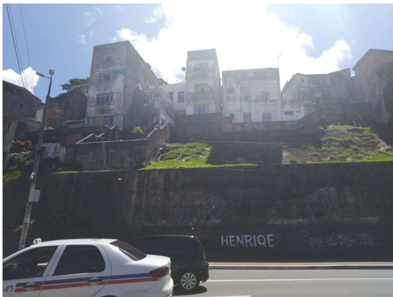
Figura 23: Local com cicatriz de movimento de massa na região da Avenida Vasco da Gama
