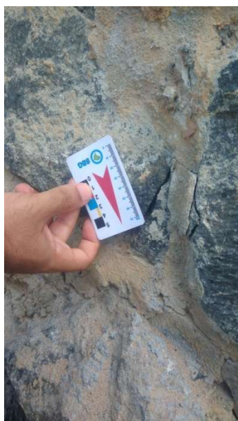
Figura 13: Fraturas da estrutura
